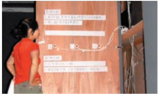
●佈滿密密麻麻電線的裝潢牆內，寫於門後的警示標語與操作程序，是美術館在技術人員離館後唯一賴以「開機」的線索。(攝影：羅潔尹)
